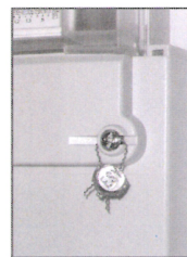
Abb. oben: Benutzersicherung für den Klemmendeckel (per Plombe)
